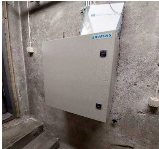
Nykyinen valvonta-alakeskus lämmönjakohuoneessa.
