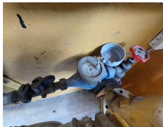
Kiinteistön päävesimittari ja alkuperäiset sulkuventtiilit.
