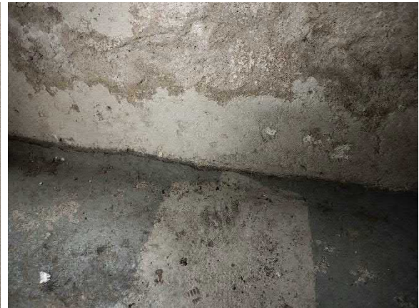
Alakerran lattian rajassa paikoittaisia vaurioita
