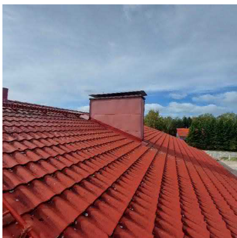
Painovoimainen rakenneaine hormi vesikatolla.
