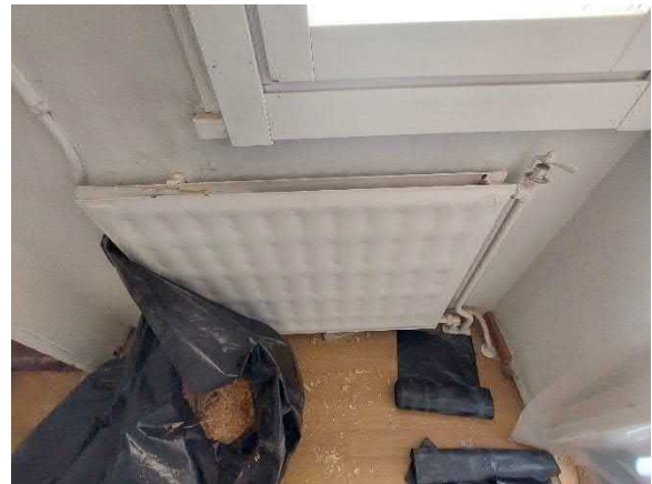
Alkuperäinen lämmityspatteri toimitiloissa.
