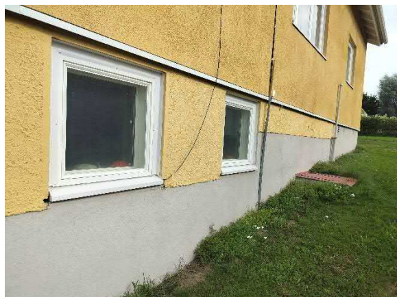
Perusmuurien ulkopuolisesta vedeneristystä ei havaittu
