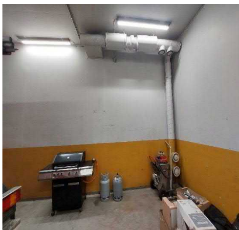
Kiinteistön laajennusosan poistoilmakanavistoa.
