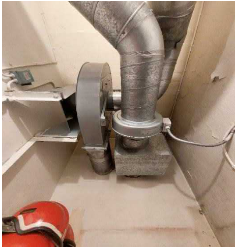
Kanavapuhallin ja savukaasuimuri kiinteistön alkuperäisellä rakennusosalla.
