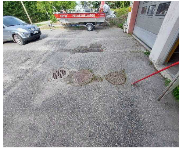
Kiinteistön sadevesi- ja perusvesikäivot.
