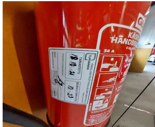
Sammuttimen edellisen tarkastuksen päivämäärä.
