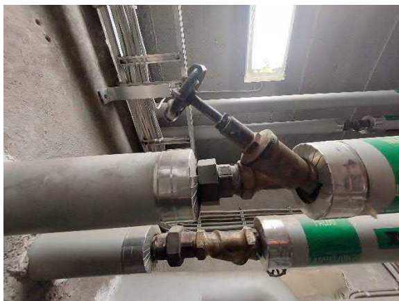
Lämmönjakohuoneessa sijaitsevat alkuperäiset sulku- ja linjasäätöventtiilit.
