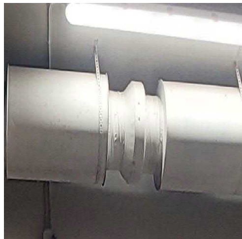
Kiinteistön laajennusosan koneellinen poistoilmanvaihto toteutettu kanavapuhaltimella.
