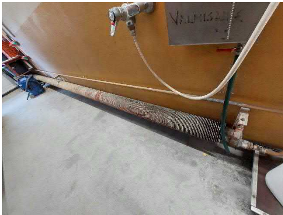
Autohallin heikkokuntoinen lämmityspatteri.
