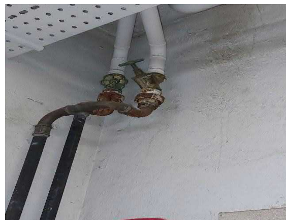
Lämpölinjat ja alkuperäiset sulkuventtiilit autohallissa.
