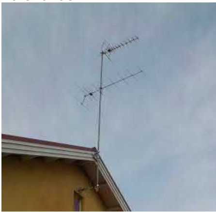
Antenneja rakennuksen päädyssä
