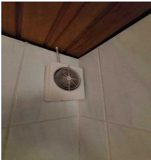
Kylpyhuoneen ilmanvaihtoa tehostettu PAX-puhaltimella.
